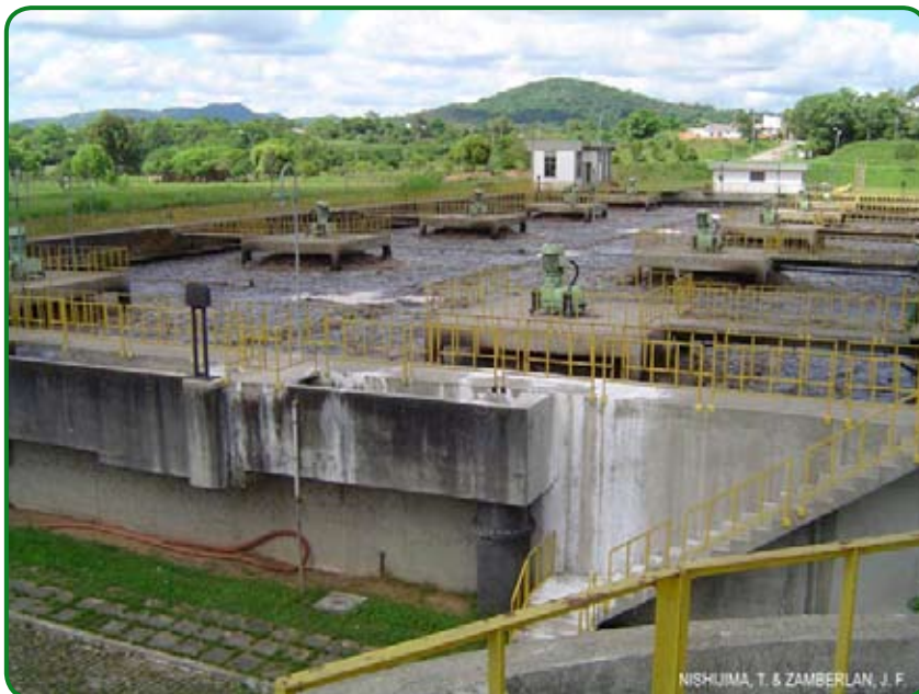
Figura 8.4 – Vista de uma estação de tratamento de esgoto.
