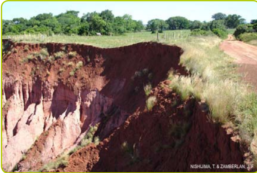
Figura 3.2 – Erosão avançando sobre uma estrada vicinal.
