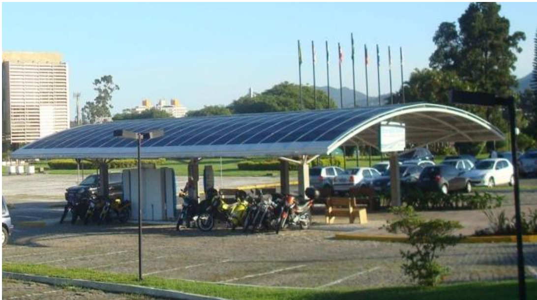
Figura 6.14 - Planta Piloto do Megawatt Solar - Eletrosul - Florianópolis - 11,97 kWp - em operação desde Fev/2009.
