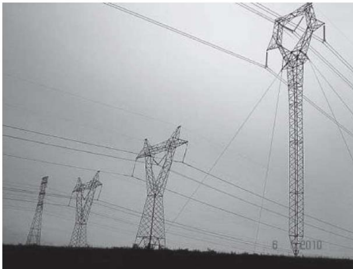
Linha de transmissão. (Cortesia de Furnas Centrais Elétricas.)
